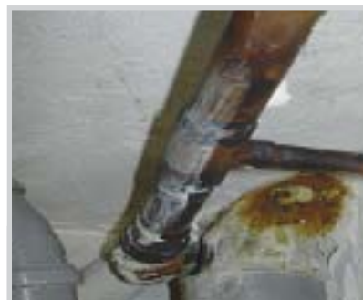
Ob Be- oder Entwässerung: So dürfen Leitungen nicht aussehen.
