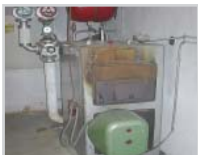
Alte Heizungsanlagen kosten viel Geld im Unterhalt und stellen ein Risiko dar.
