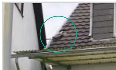
Kaum sichtbar: Lose Dachziegel können für das ganze Dach gefährlich sein.
